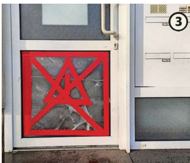
(3) Wurde laut Mietern Monate lang nicht repariert: Die Eingangstür einer LEG-Immobilie in Alsdorf.
